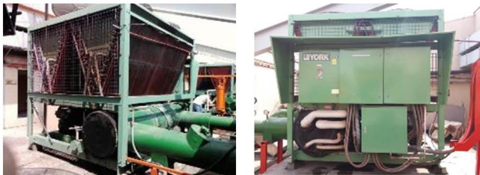
Hệ thống chiller cũ
