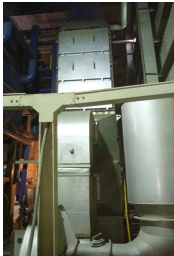
Bộ hâm nước tại nhà máy
